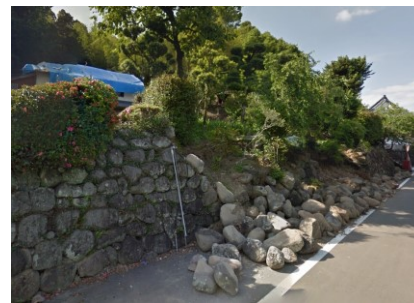
熊本地震で崩壊した中村家の石垣
