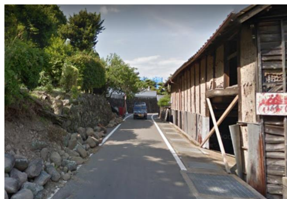
熊本地震で崩れた石垣 H28.5撮影
